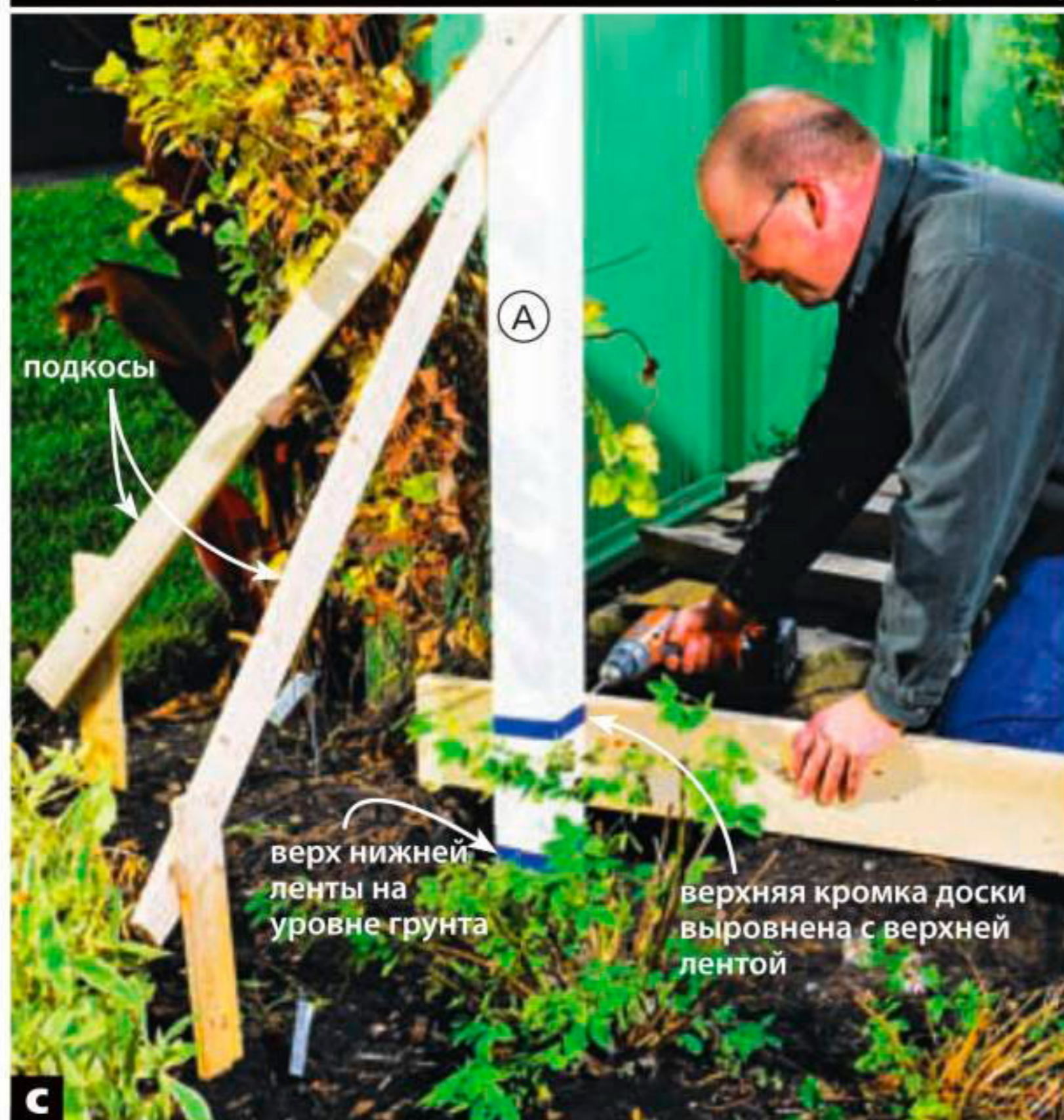
С Установив крайний столб А вертикально и зафиксировав его подкосами, прикрепите доску 40×150×2440 мм вровень с верхним краем верхней ленты.
